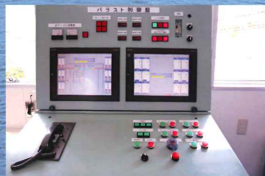
バラスト制御盤
